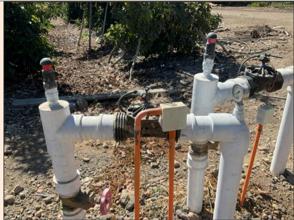
Sistema de Cluster de riego. Sector Cavancha
