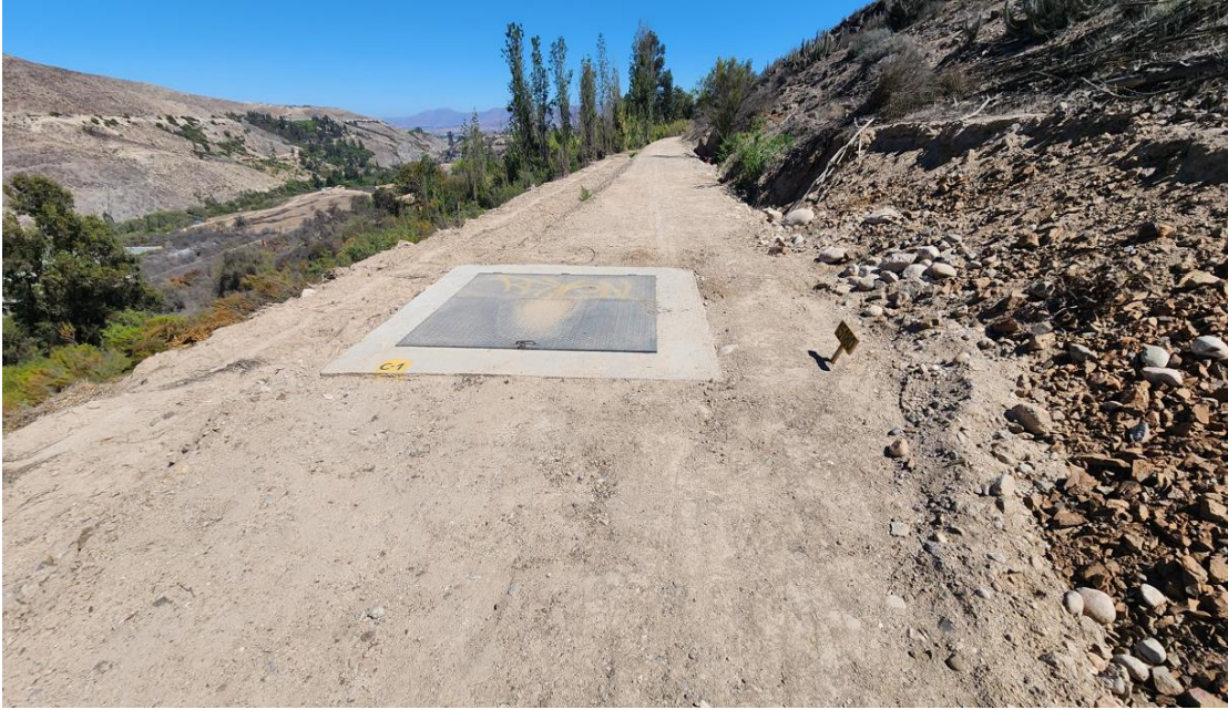
Figura N°24: Fotografía de cámara de inspección.
