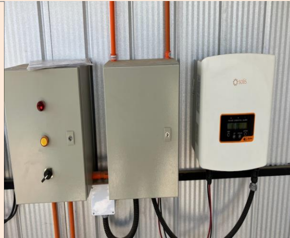
Sistema on-grid- Tablero de control-tablero de distribución- inversor Ongrid
